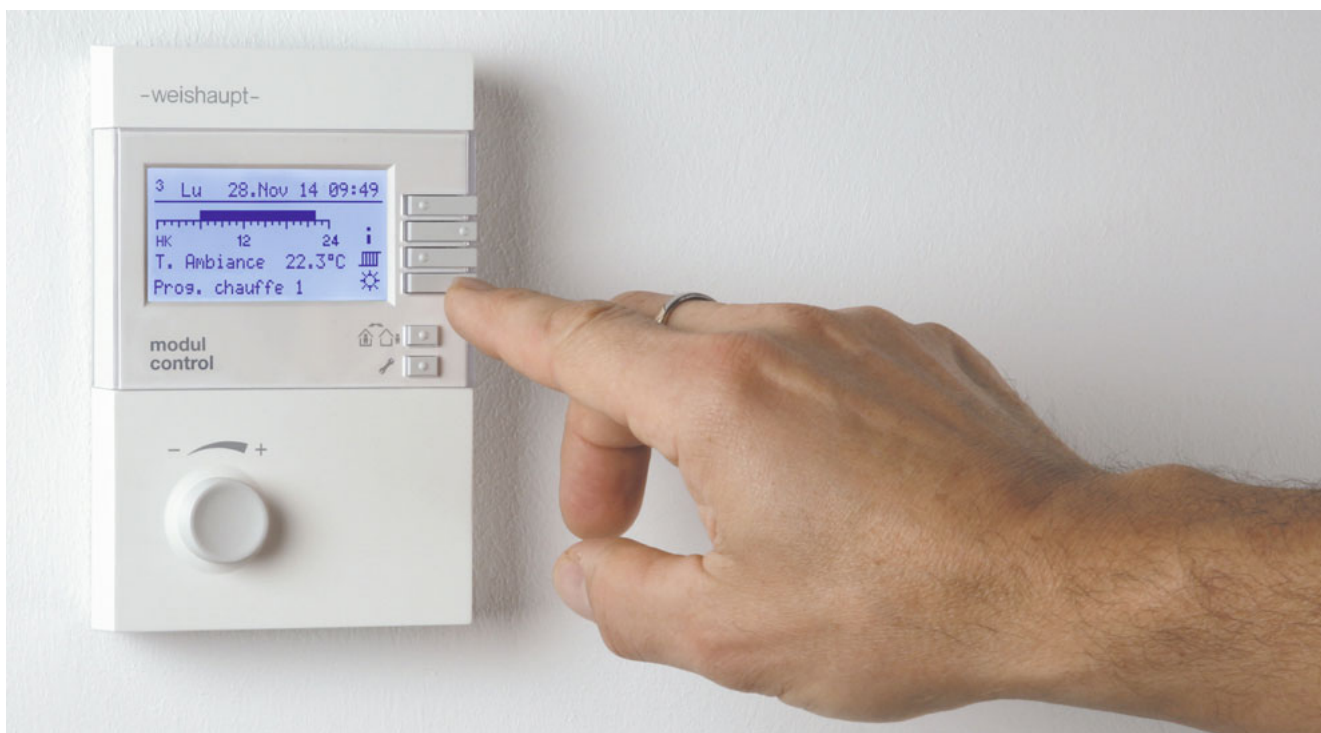
L'installation de chauffage est pilotée par la commande à distance WCM-FS
